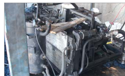
Figura 1: Estación de aire comprimido descuidada
